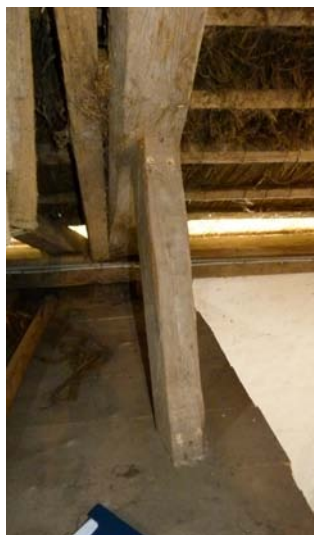
Et spær ved porten er knækket og derfor understøttet.
