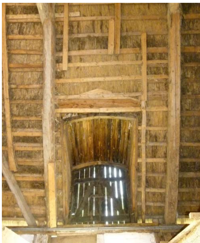
Spærfaget med kvisten. Tagets buede underside af brædder er sort af rå – skal skiftes.
