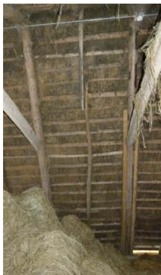
Et spær er forstærket i 1983 – denne reparation bevares.
