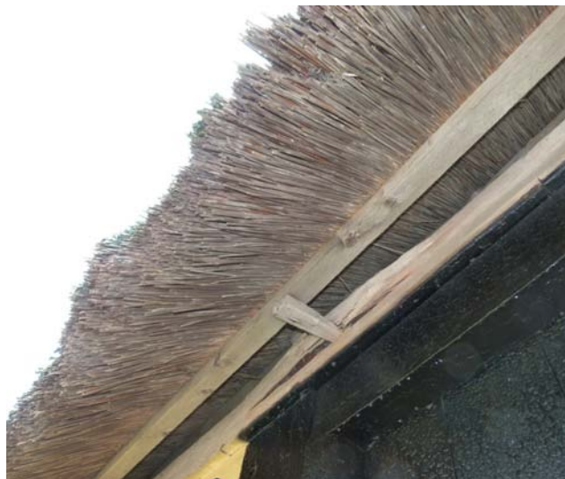
Udvendig ses hvordan mange års utæthed har givet råd i tagemme – spærenden er ”på vej ud”. Remmen skal skiftes.
